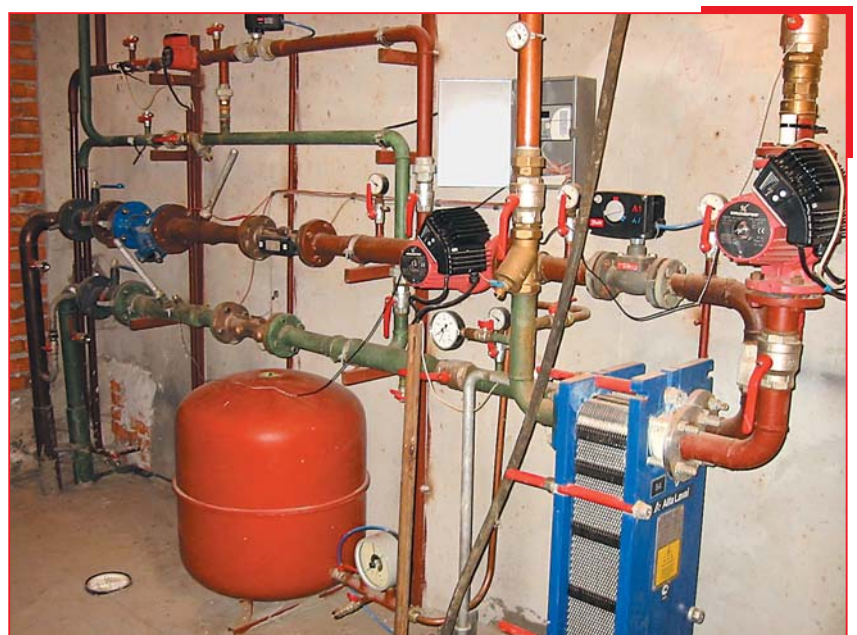
▼ Рис. Индивидуальный тепловой пункт на базе оборудования «Данфосс»
