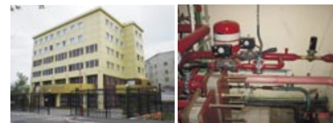
Офисное здание агентства по антимонопольному регулированию. Для автоматизации теплового пункта применены электронный регулятор ECL Comfort 300, регулятор перепада давления, седельные регулирующие клапаны, редукторные электроприводы, для независимой схемы присоединения контуров отопления и горячего водоснабжения.
